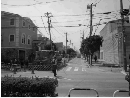
写真1 傾いた電柱 今川2丁目
