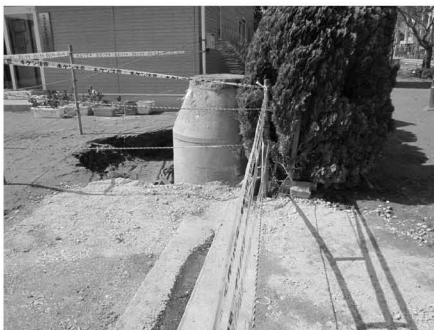
写真2 抜け上がったマンホール 明海
