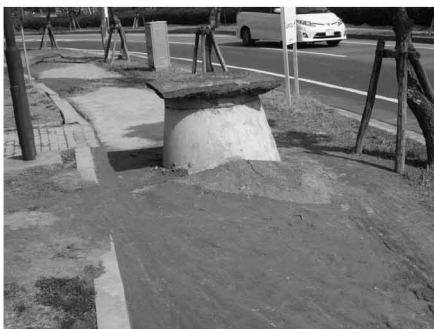
写真3 抜け上がったマンホール 切られたアスファルトが載っている 前方にもある
