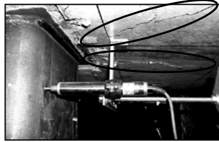
写真 3. 2. 2. 3 Fp4 柱前後面近傍ひび割れ状況
