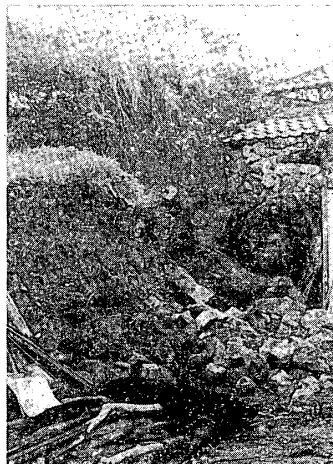
写真2 平原地区擁壁崩壊。(5月28日撮影)
