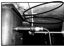
写真1 Fp.4 柱前後面近傍ひび割れ状況
