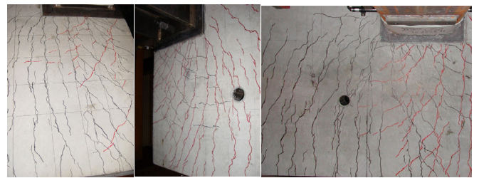
図 5 最終ひび割れ状況
