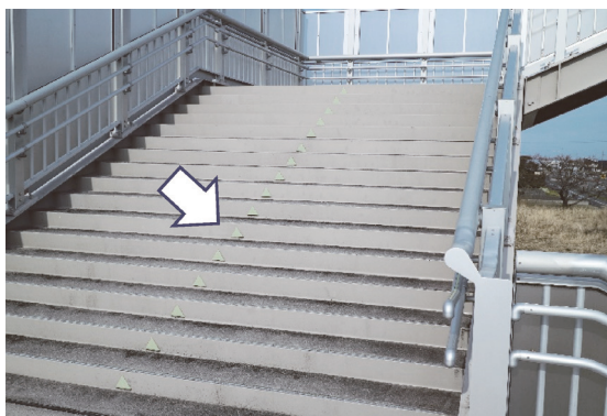
避難階段の蓄光式避難誘導板
