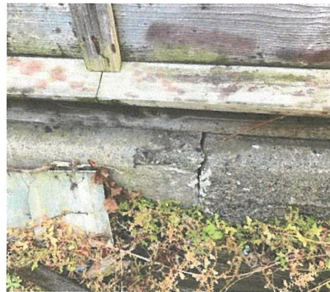
図 7-24 亀裂箇所の拡大図
