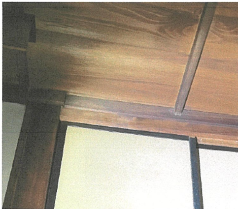
図 7-17 玄関ホール廻縁にみられた切断箇所
