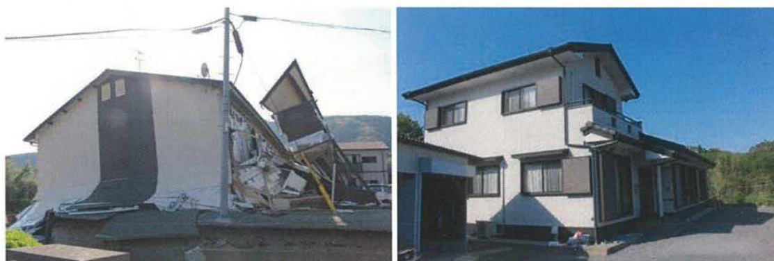
a)層崩壊した木造アパート
