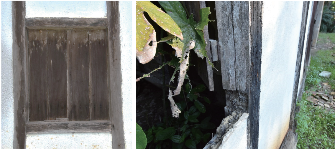
写真 2-1-8 「住居」の真壁造りの窓 写真 2-1-9 「住居」の窓台が外れた柱の仕口 枠
