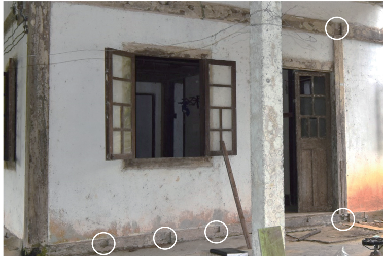
写真 2-1-6 ベランダの桁と土台に見られる痕跡（○印は梁と根太の痕跡）
