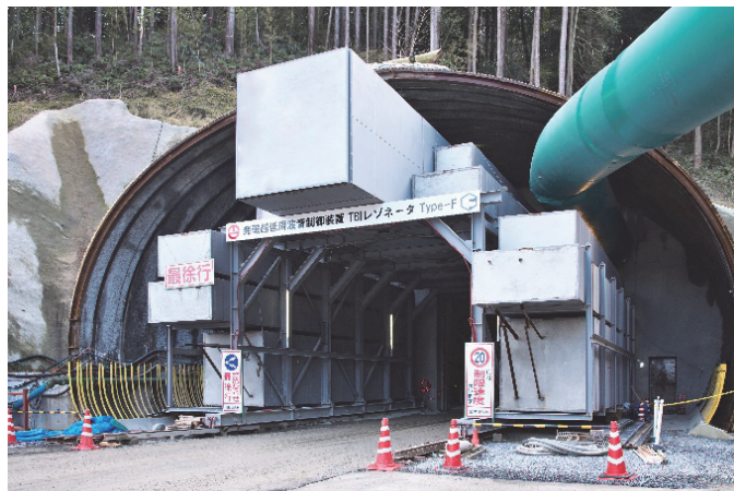
写真1 トンネル現場での消音装置の設置状況 (撮影: 西山芳一)
