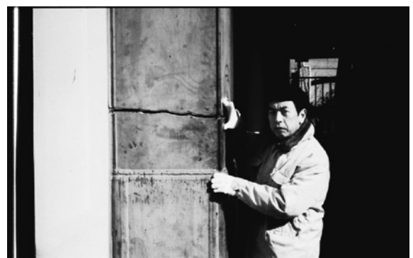
図20 柱材の引張破壊
