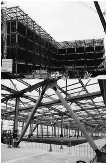
図38 DPL 川崎夜光物流施設
