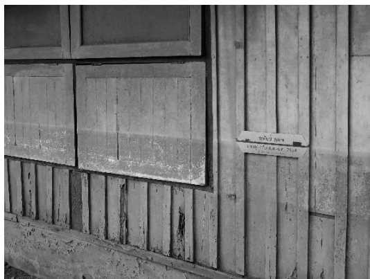
写真 22 壁に記録された洪水の跡
