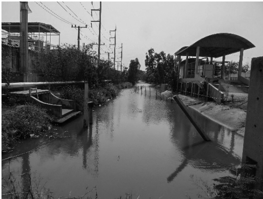
写真 27 排水路と排水ポンプ
