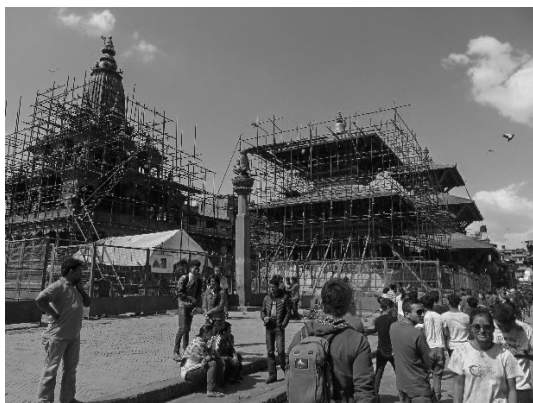
写真5 被災した歴史的建造物
