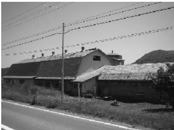
写真9 プンカ屋根同士の接ぎ(左方)と, 平屋の牛舎との接ぎ(右方)の両方を確認できる。 (2005. 7. 13 興部町秋里・筆者撮影)
